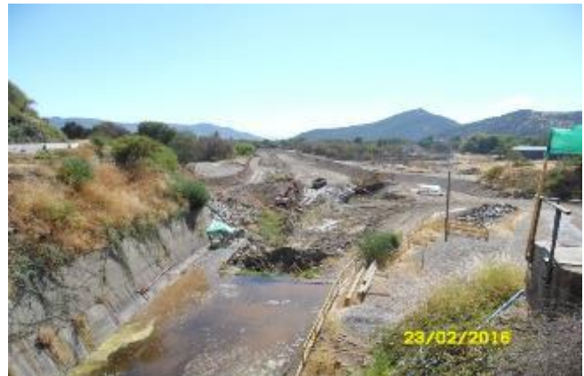
Canal de Descarga y sistema de evacuación de las aguas del canal y de la excavación de la Casa de Máquinas hacia el Canal Molino San Luis, que nace del Canal Santa Adela.
