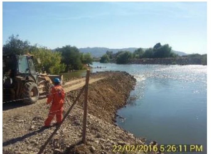
Construcción de Ataguía en la desembocadura del Canal de Restitución con el Estero Chimbarongo.
