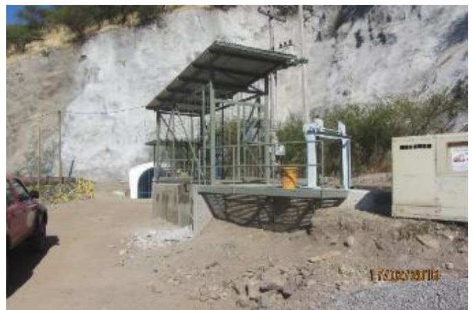
Cámara de Válvulas terminada, con su jaula techada, válvula de Mariposa y válvula Howell Bunger. Sólo faltan retoques de pintura. Se aprecia la Compuerta Plana Metálica reinstalada a la salida de la Cámara de Válvulas, el Canal Santa Adela y parte del Sifón.
