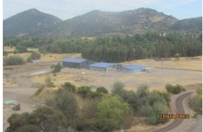
Vista panorámica desde el Muro lado Sur de la Instalación de Faenas. Se aprecia excavación Fundación Grúa Torre, Patio de desechos y Estacionamiento Techado en construcción.
